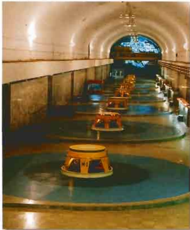
Gian máy Machine hall
