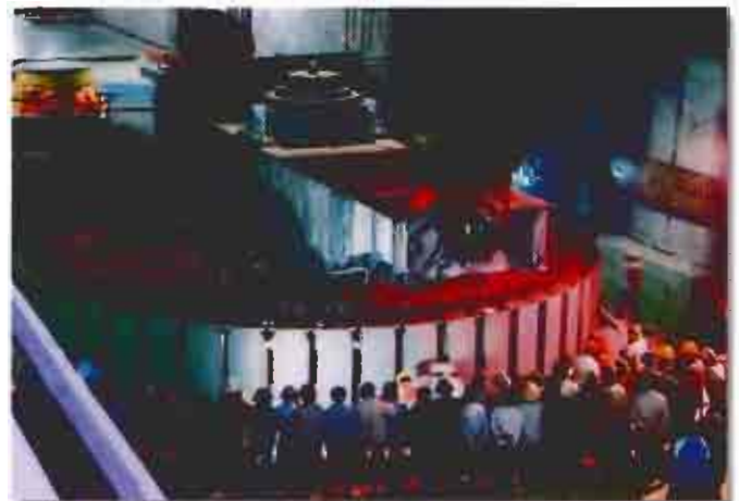
Rotor máy phát điện đang được lắp đặt Installation of Rotor Electric Generator
