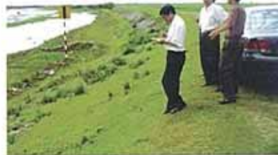
Kè Ngòi Quyền trên sông Đáy đang sạt lở
